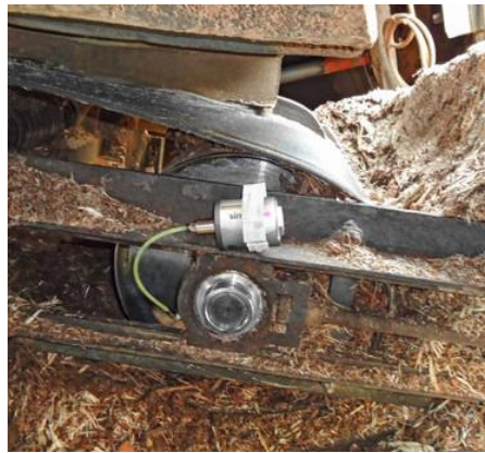
컨베이어 벨트의 Y볼 베어링 유닛에는 윤활유가 지속적으로 공급됩니다.
